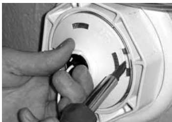
Ceci pourrait également être nécessaire lors de l'installation d'une lumière LED.
